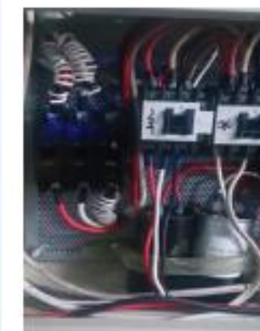
冷凍庫壓縮機 (田園)
