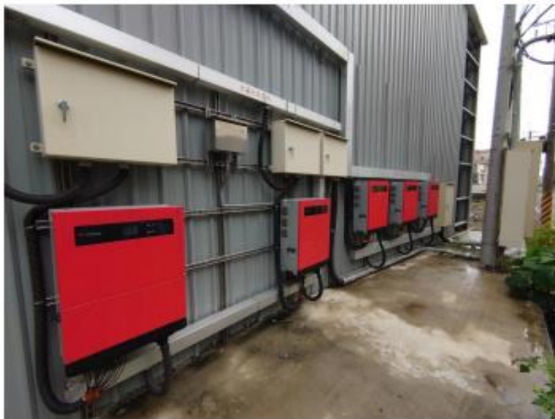
屏東東港太陽能電廠 263K 降諧波節電組件安裝位置
