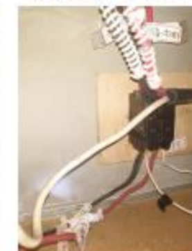
冷氣電源 (電機事務所)
