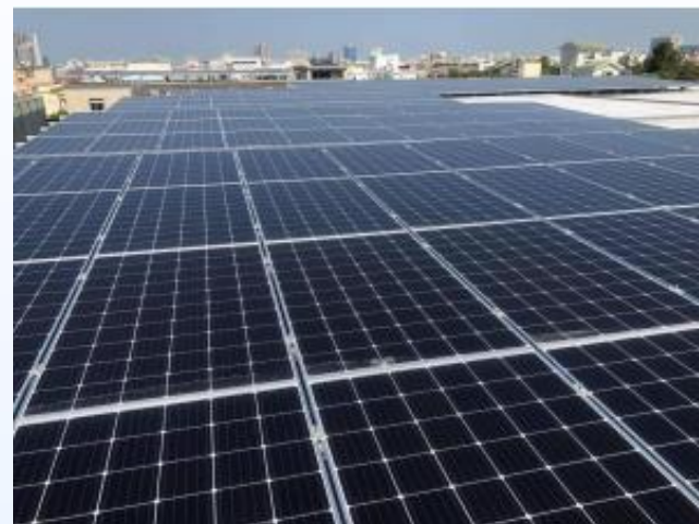
太陽光電發電系統 台南安平工業區電場
