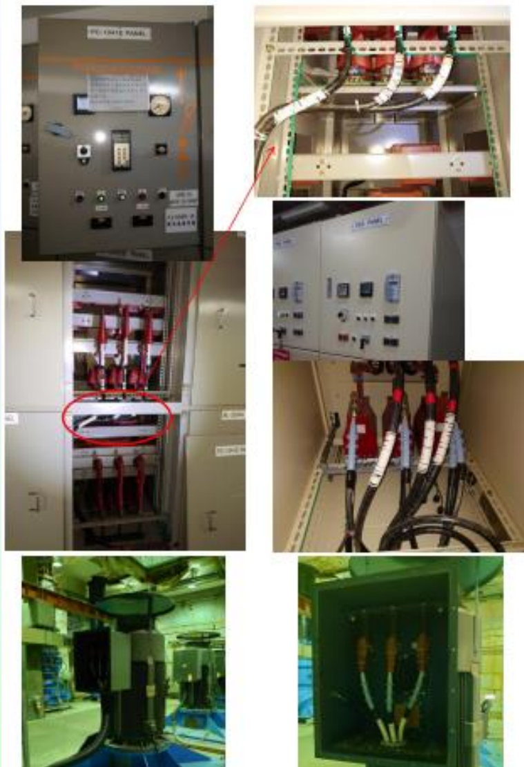
內湖汙水處理廠-進流抽水機 69KV
