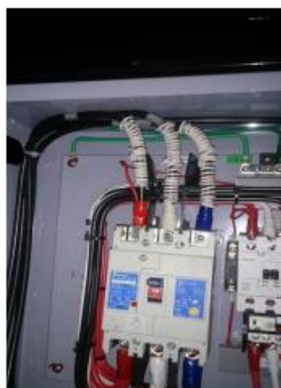
冰水主機 (國泰神坊)
