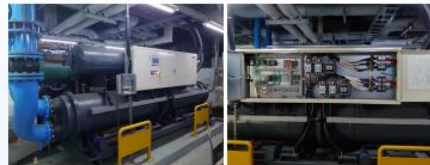
台南市安南區工業 300 噸冰水主機 降諧波節電組件安裝位置
