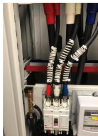
配電盤 (國泰神坊)
