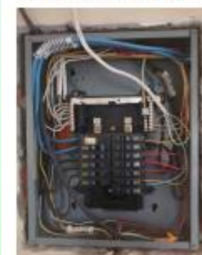
配電盤 (電機事務所)
