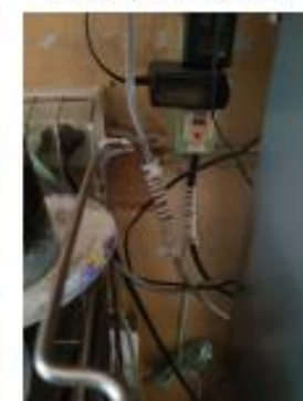
冰箱 (電機事務所)
